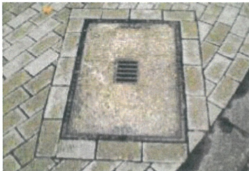
Einbauten sollten fachgerecht umpflastert werden
